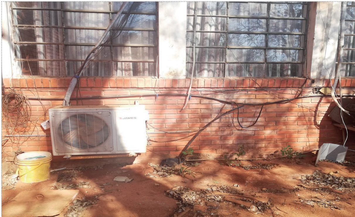
Foto N° 11: Área del bloque 1, donde se observa los aglomerados de cables de comunicación, eléctricos, de aire acondicionados y la contaminación por basuras solidas.
