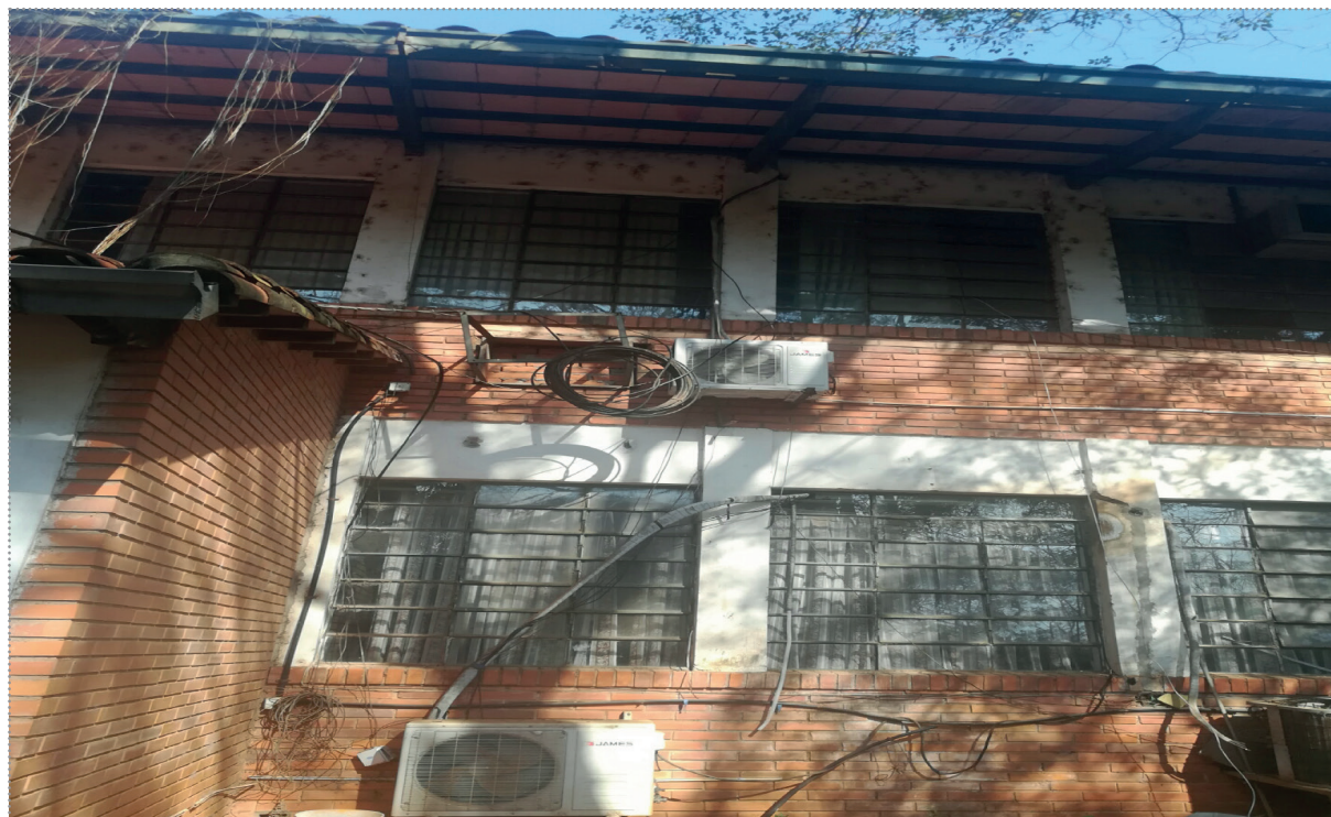
Foto N° 4: Área norte del bloque 1, donde se observa los cables eléctricos y de comunicación aglomerado y expuestos a la intemperie.
