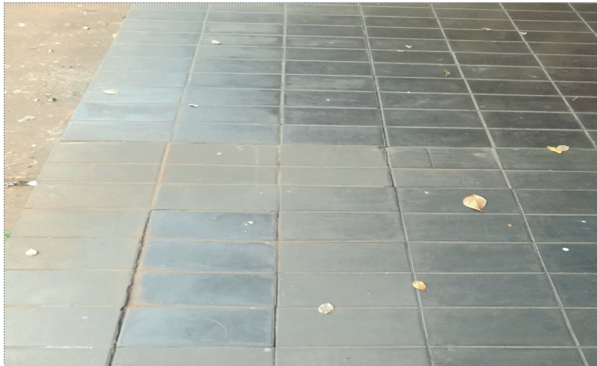
Foto N° 7: Área del piso del bloque 1, en donde se observa la descomposición de la misma.
