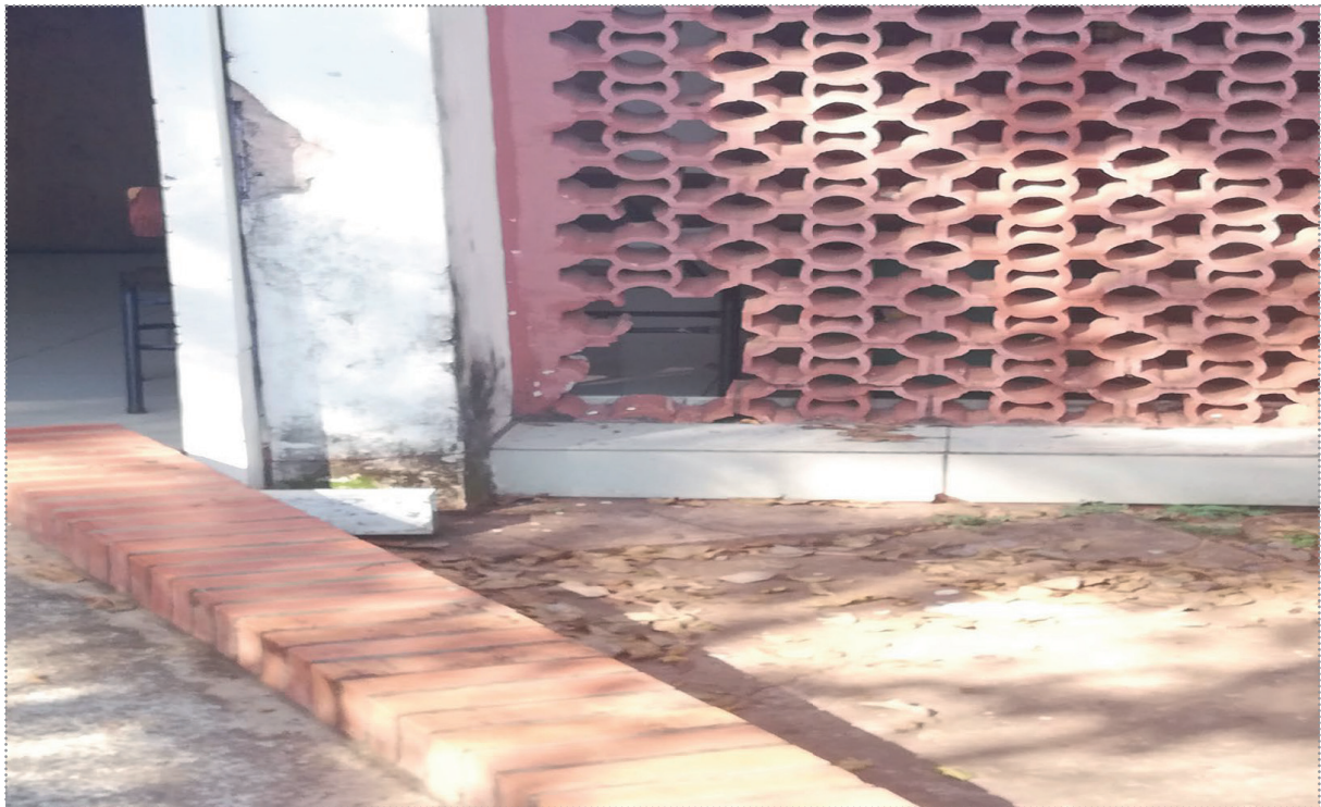
Foto N° 14: Área del Multiuso, donde se observa los ladrillos huecos rotos.
