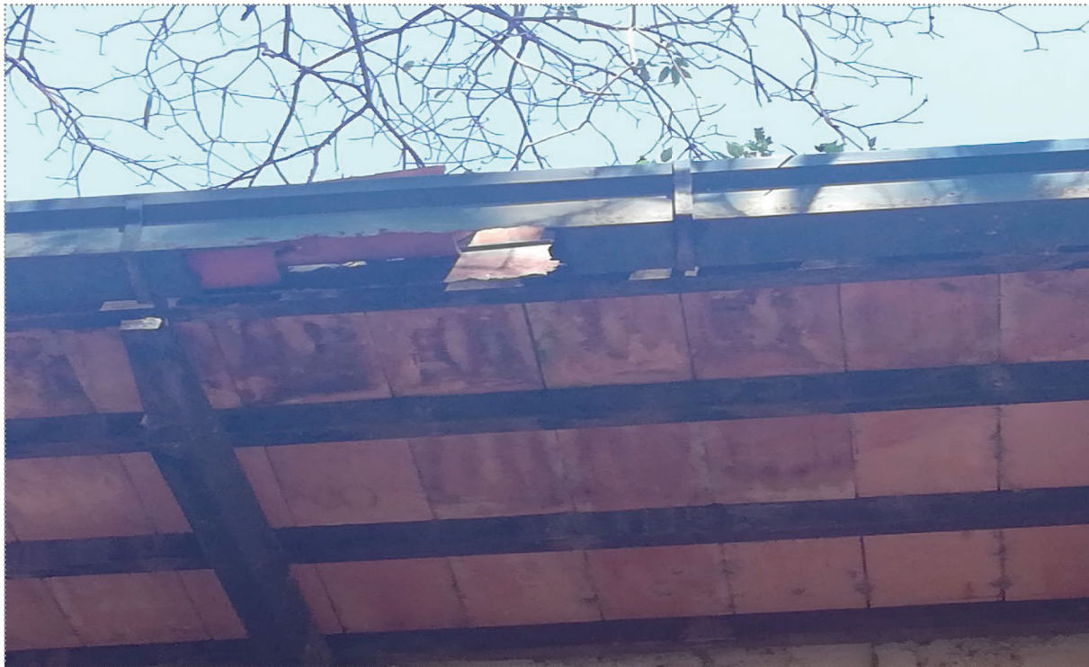
Foto N° 12: Área del bloque 1, donde se observa el techo destruido y la canaleta de desagüe fluvial.
