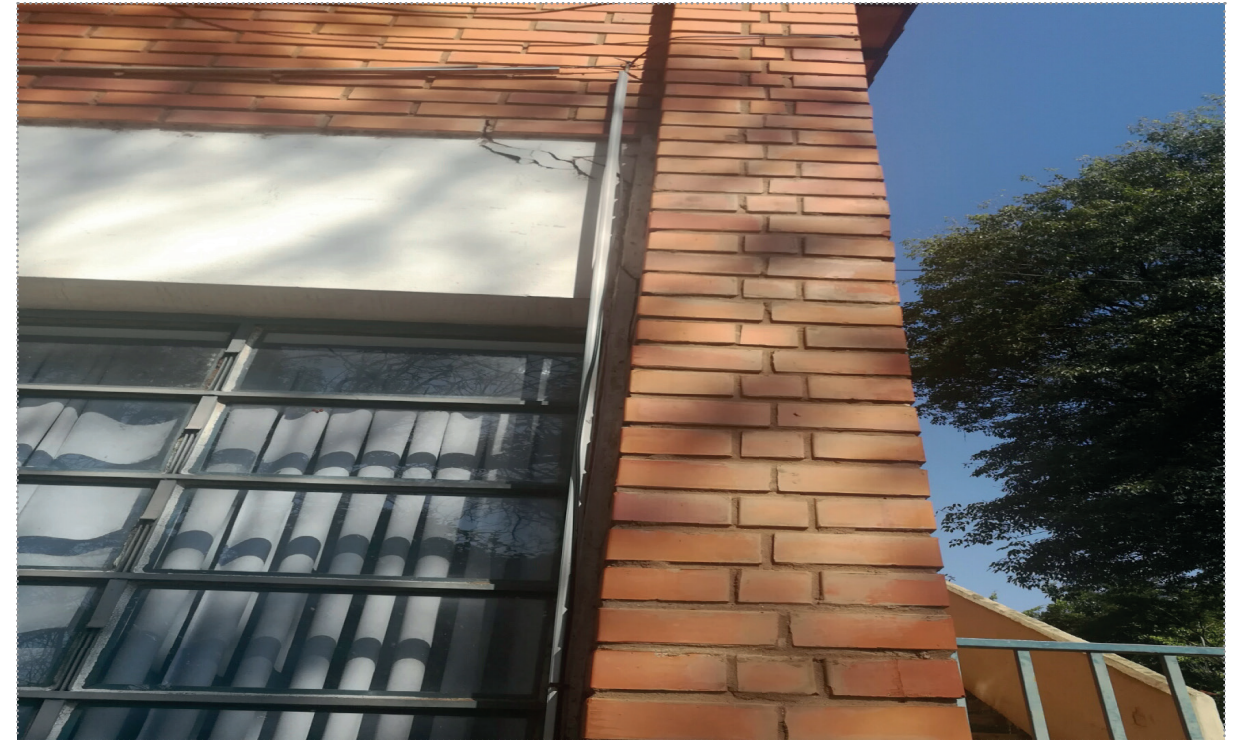
Foto N° 1: Área del bloque 1, donde se observa la fisura de la estructura de hormigón.
