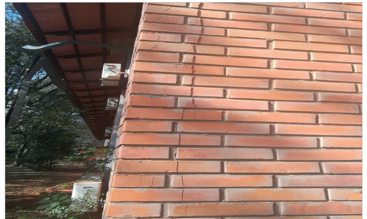
Foto N° 2: Área del bloque 1, donde se observa la fisura de los ladrillos evidenciando la vulnerabilidad de la estructura del hormigón.
