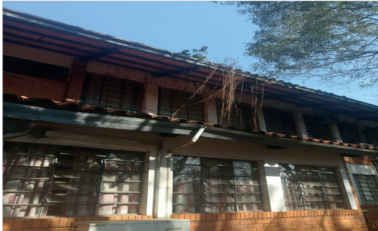
Foto N° 3: Área norte del bloque 1, donde se observa la avería de la canaleta de desagüe, las tejas rotas y el deterioro de la pintura.
