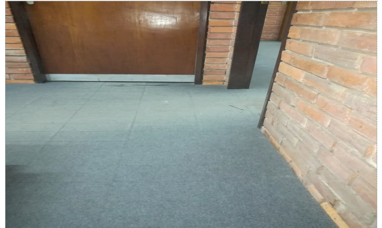
Foto N° 5: Área del bloque 1, sala de espera donde se observa los ladrillos del cimiento alterados.
