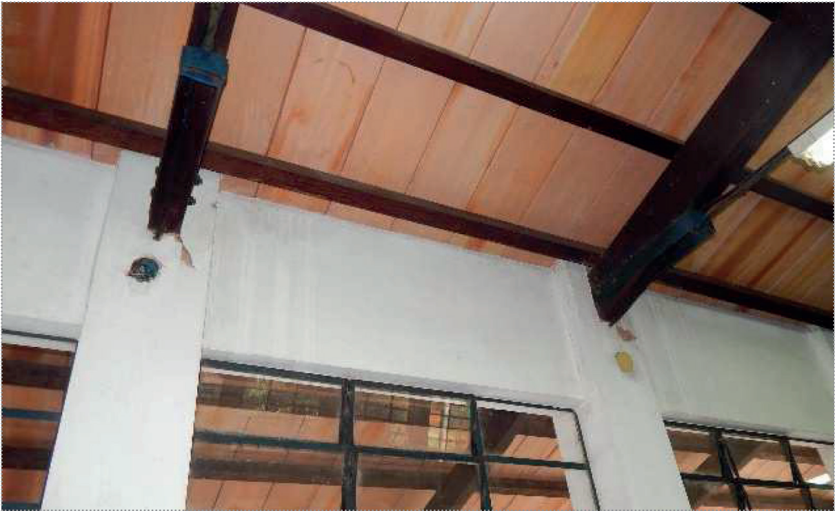
Foto N° 16: Existen fisuras por asentamiento diferencial, manchas de humedad en muros a causa de filtraciones por fisuras y pérdida de impermeabilización de los ladrillos. Biblioteca INAES.
